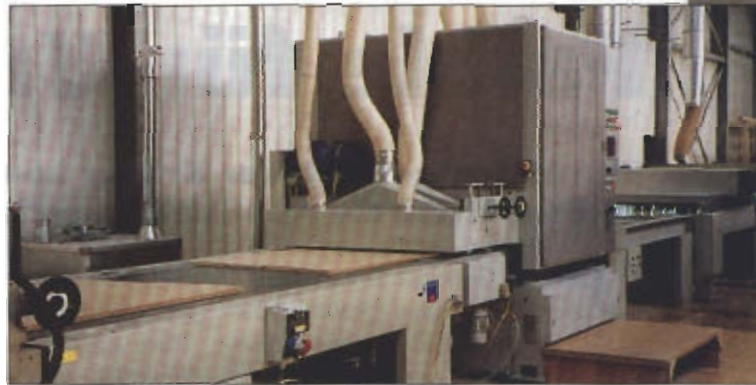
Schleifstation für Lackzwi- schenschliff in der Oberflächen- lackierung für Bekleidungen, Laibungs- elemente und Türblätter
